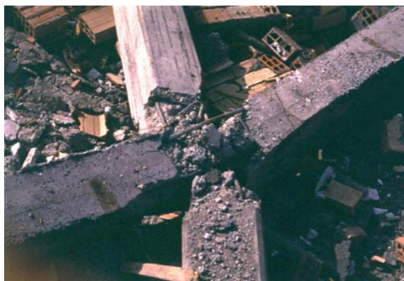
ساختمانی بتنی در رشت که به دلیل ضعف اتصالات در زلزله منجیل ۱۳۶۹ منهدم شد
